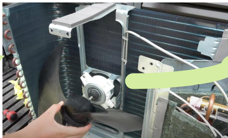
エアコン室外機のファンモータ
